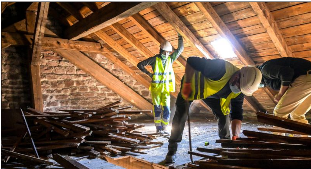
La déconstruction d'un bâtiment de l'ancienne usine Bragard sera suivie d'une vente publique des matériaux. Un concept innovant. Photo VM/Jérôme HUMBRECHT
